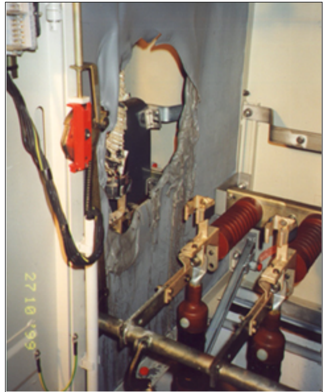
Bild 2: Totalausfall einer Schaltzelle
