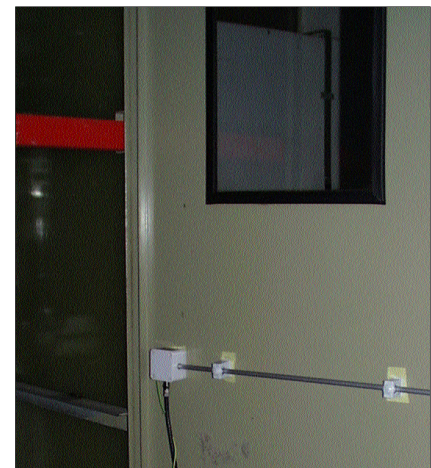
Bild 7: Feldsonde IDPS-A, montiert an der Innenseite einer Schaltzelltür
